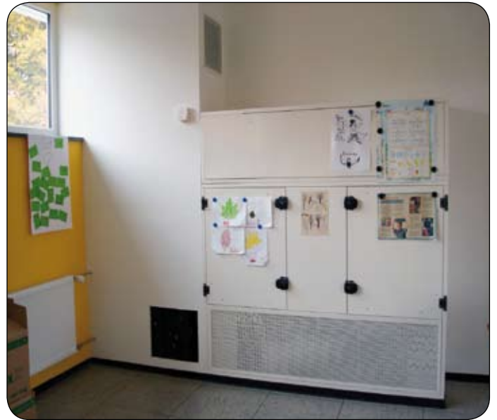
Grundschule Sailauf (Rosenberg Ventilatoren)
