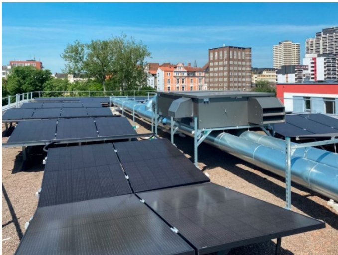
Ein Kreuzgegenstrom-Wärmeübertrager sorgt bei diesem Projekt für erhebliche Heizenergieeinsparung. Bild: Airflow Lufttechnik GmbH
